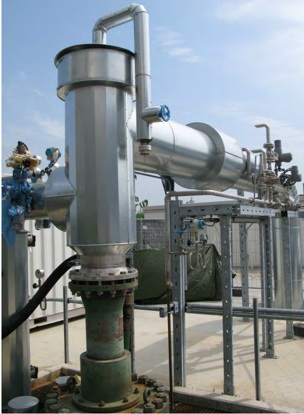
Figur 20: Brunnenkopf des Geothermie-Kraftwerks Unterhaching, Südbayern. Die Gesamthöhe beträgt ca. 3 m.
