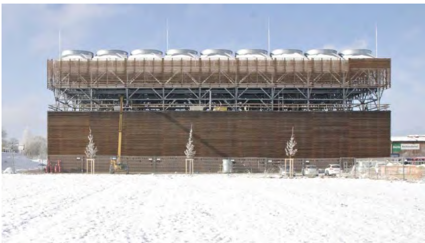
Figur 24: Raumsparend installierte Luftkühlung über dem Geothermie-Kraftwerk Sauerlach, die derzeit grösste Anlage in Deutschland. Ansicht der Gebäuderückseite (Quelle: SCG Architekten, München).
