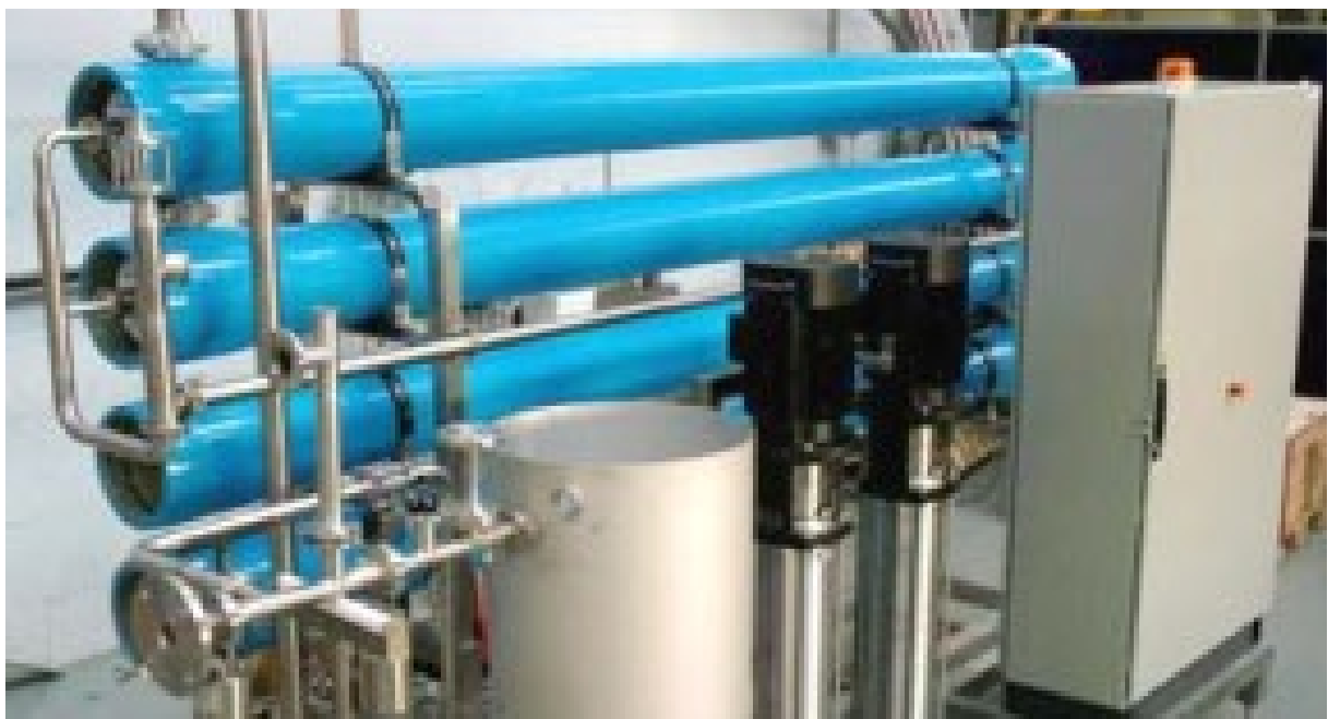
Abbildung 31: Einsatz einer Nanofiltrationsanlage (Anlage der MMS AG)
