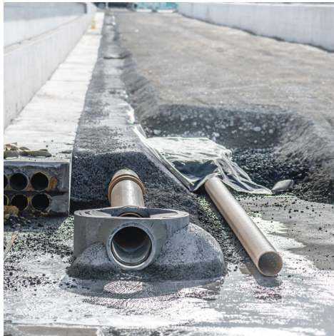
Das Grundwasser wird durch Rohre geleitet und kann so ungehindert zirkulieren
